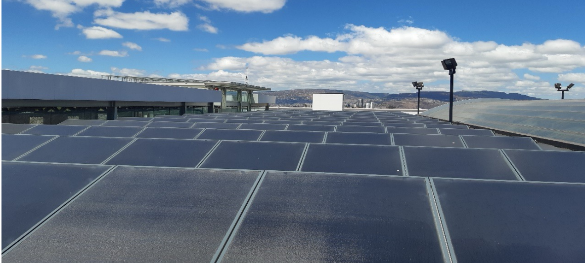
Sistema solar térmico Edificio 1847, Universidad Nacional Autónoma de Honduras
