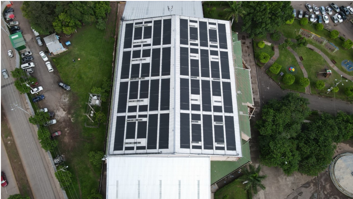
Sistema solar térmico piscina olímpica Tegucigalpa MDC.
