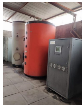
Figura 15 - Bomba de Calor, Unifrutti, Chile. Fuente: (Unifrutti) 26
